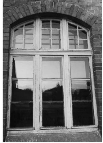
Nr. 101. XX a. pr. Visuomeninės paskirties raudonplyčio pastato langas. V. Kucino nuotr. 2012 m.
